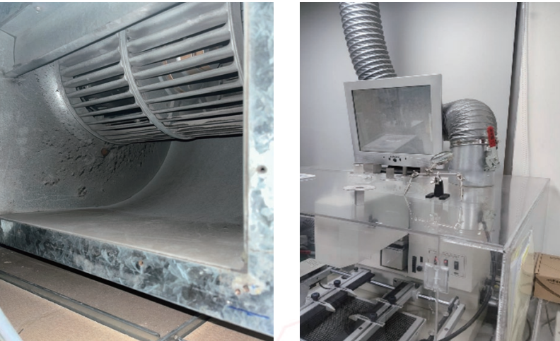
排風設備及定期檢查
